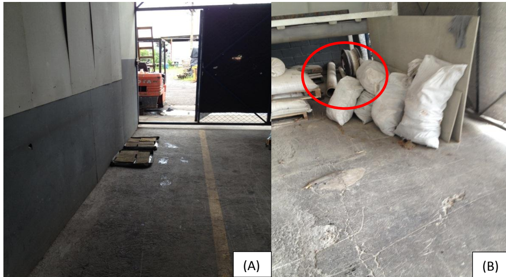
Figura 16. Ejemplos de futuras medidas correctivas en la planta Concentrados APM. S.A. A) Área de diluvios. B Manejo inadecuado de desechos y herramientas.
