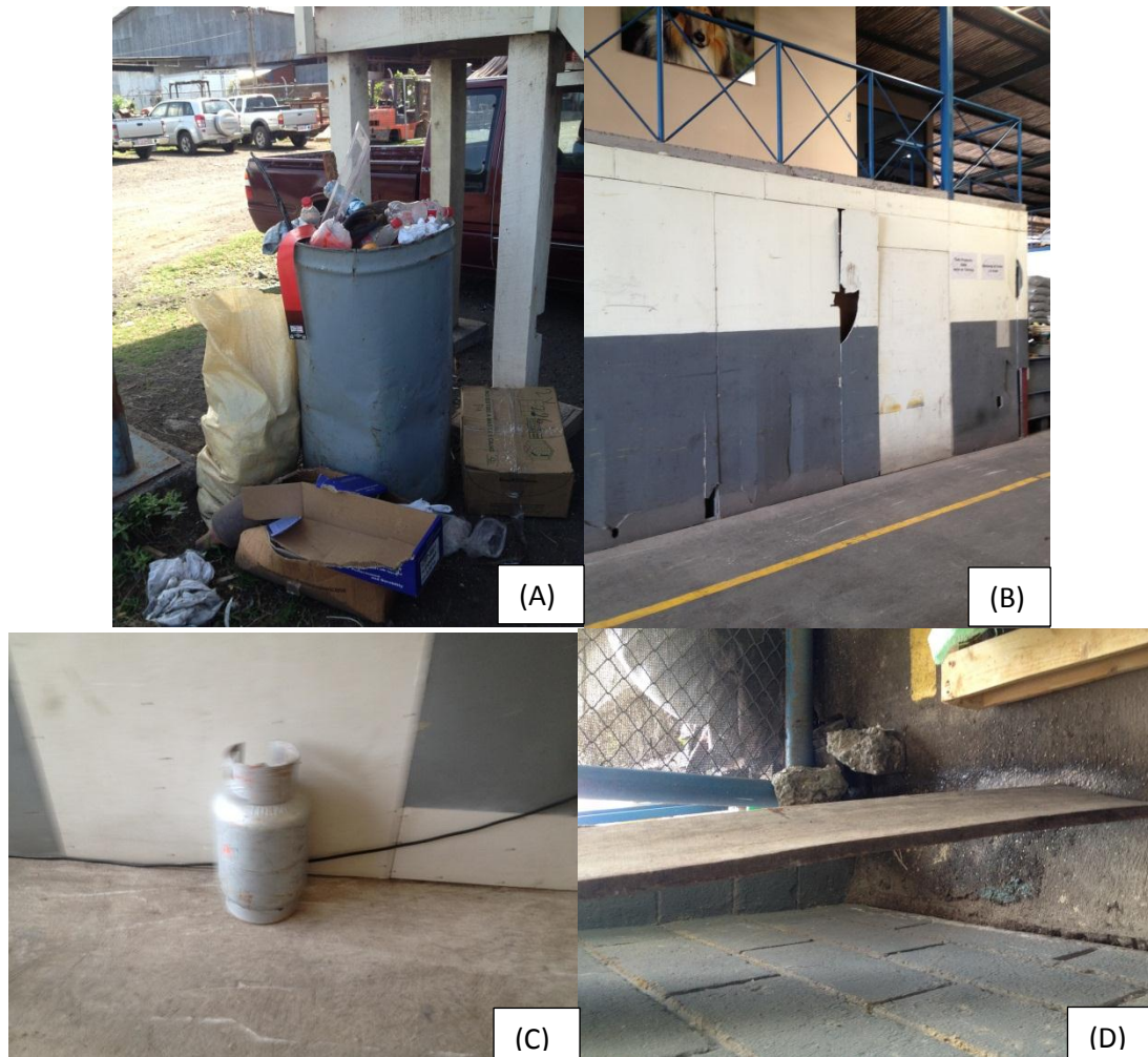
Figura 4. Fotos de inconformidades en las instalaciones. A) Manejo incorrecto de basureros. B) Presencia de huecos en las paredes. C) Objetos mal ubicados. D) Presencia de escombros en el interior de la planta. Alajuela. 2013
