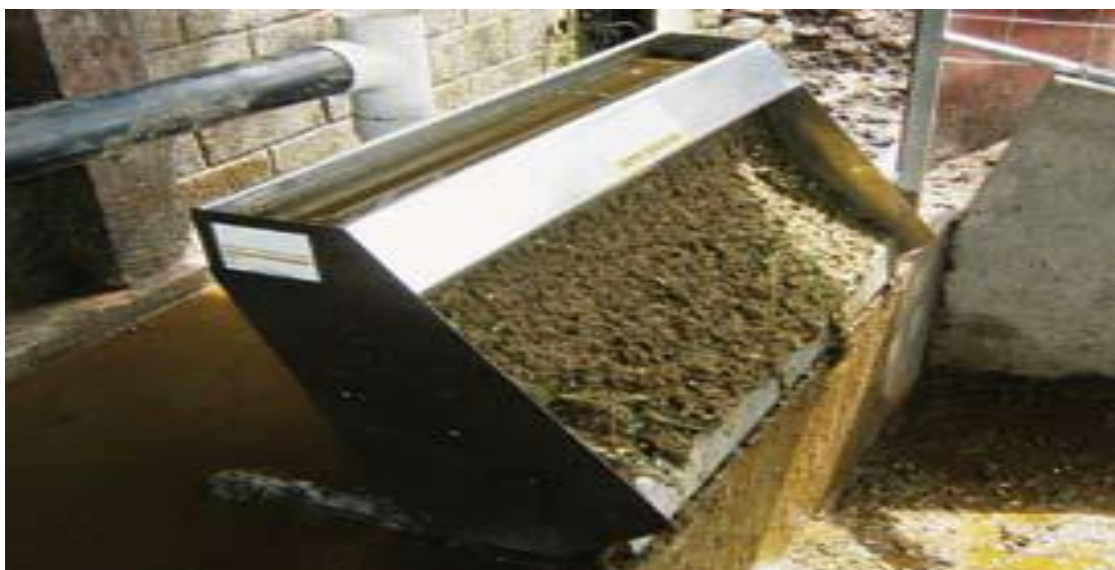
Figura 4. Separador de sólidos de malla inclinada.
